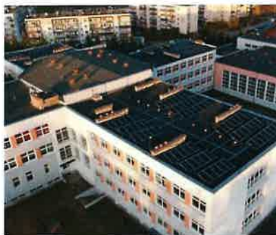
Panele fotowoltaiczne na obiekcie użyteczności publicznej
